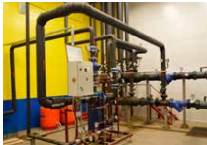
Установленный ИТП, «Мегастрой», ул. Гаврилова, г.
